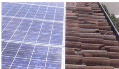
UN TETTO DEVASTATO DALLA GRANDINATA ABBATTUTASI SUL VENETO TRA MAGGIO E GIUGNO: MOLTI COPPI SONO ROTTI, MA L'IMPIANTO FOTOVOLTAICO VP SOLAR È RIMASTO PERFETTAMENTE INTEGRO
